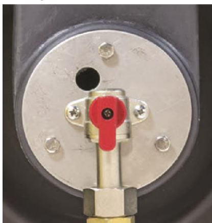
Válvula de corte en posición CERRADA
